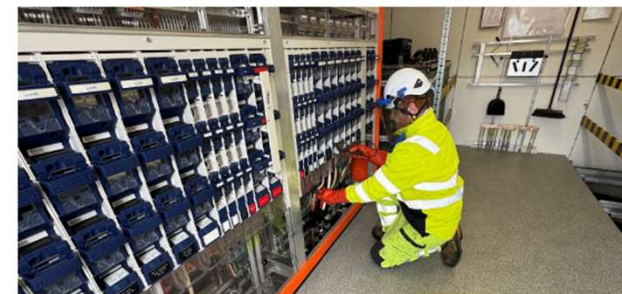
13.1.1.12 Vérification de l'absence de tension à la sortie d'un câble d'un tableau de distribution
